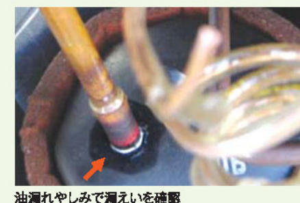
油漏れやしみて漏えいを確認
