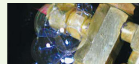
発泡液で漏えいを確認
